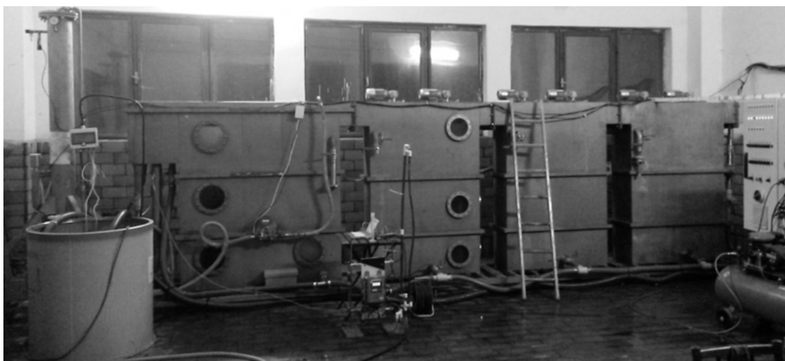
Obr. 1. ÚV Písek – umístění modelu flotace v objektu úpravy vody
